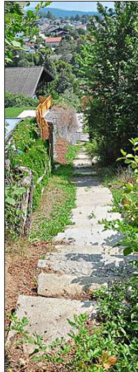
Die Natur erobert sich den Treppenweg an der Hochstraße zurück, der seit 2017 wegen Baufälligkeit gesperrt ist. Maximal 100 000 Euro lässt sich die Stadt die Sanierung kosten. – Foto: Fuchs
